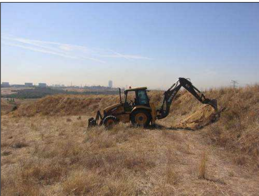
Realización de calicata al pie de una de las zonas de vertido de escombros
