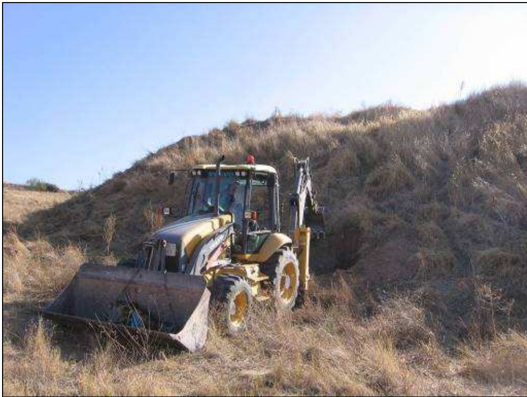
Realización de calicata al pie de una de las zonas de vertido de escombros
