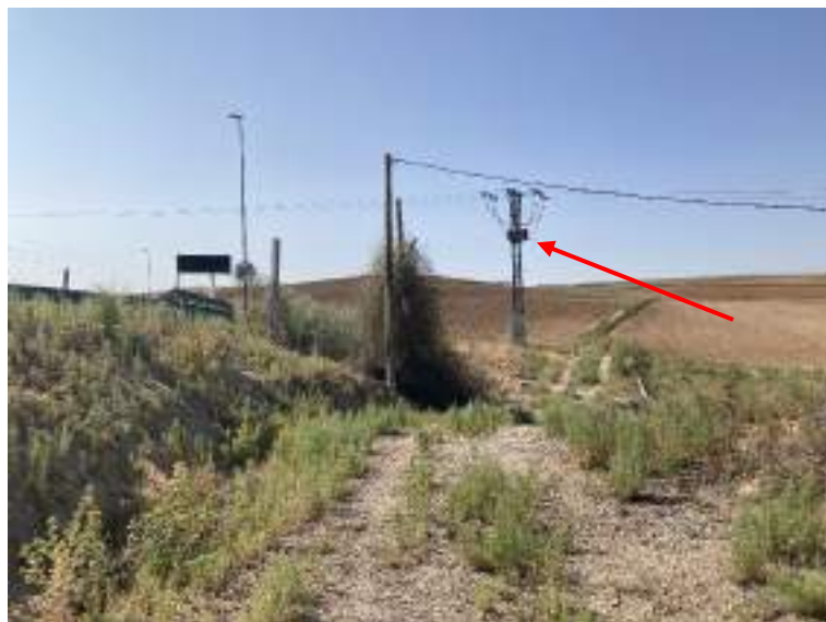
Imagen 7. Zona de paso – acceso y línea de conexión
