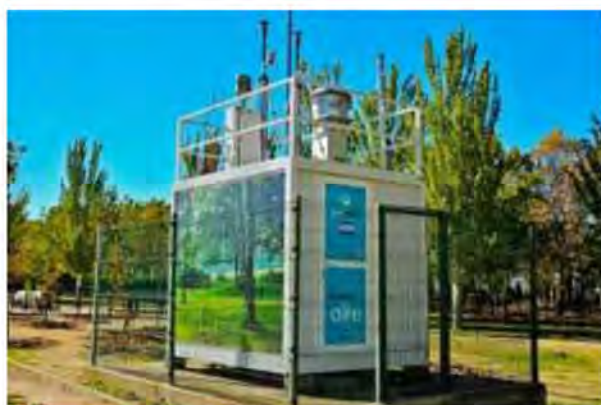
Fotografía 1. Estación de medida de la calidad del aire. Torrejón de Ardoz. Fuente Madrid.org.
