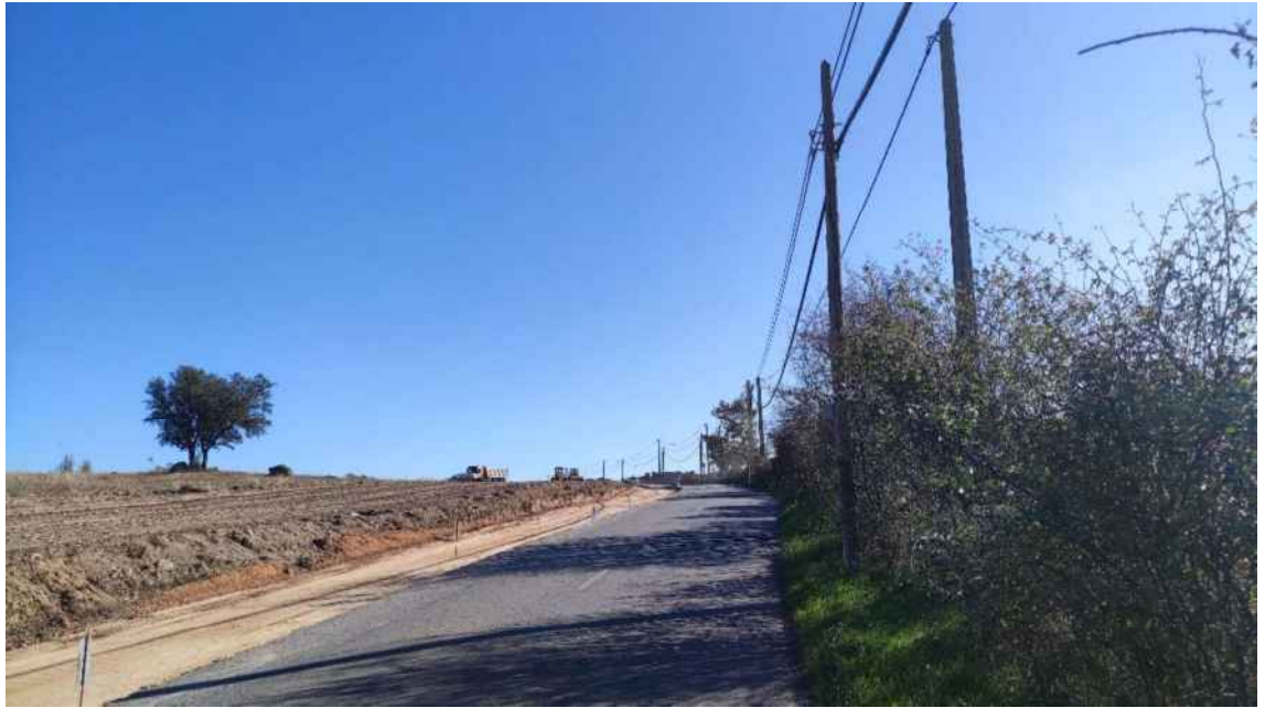
Figura 85. Obras de construcción del carril bici en el camino del Valle, 26 de octubre 2021. Fuente: elaboración propia.
