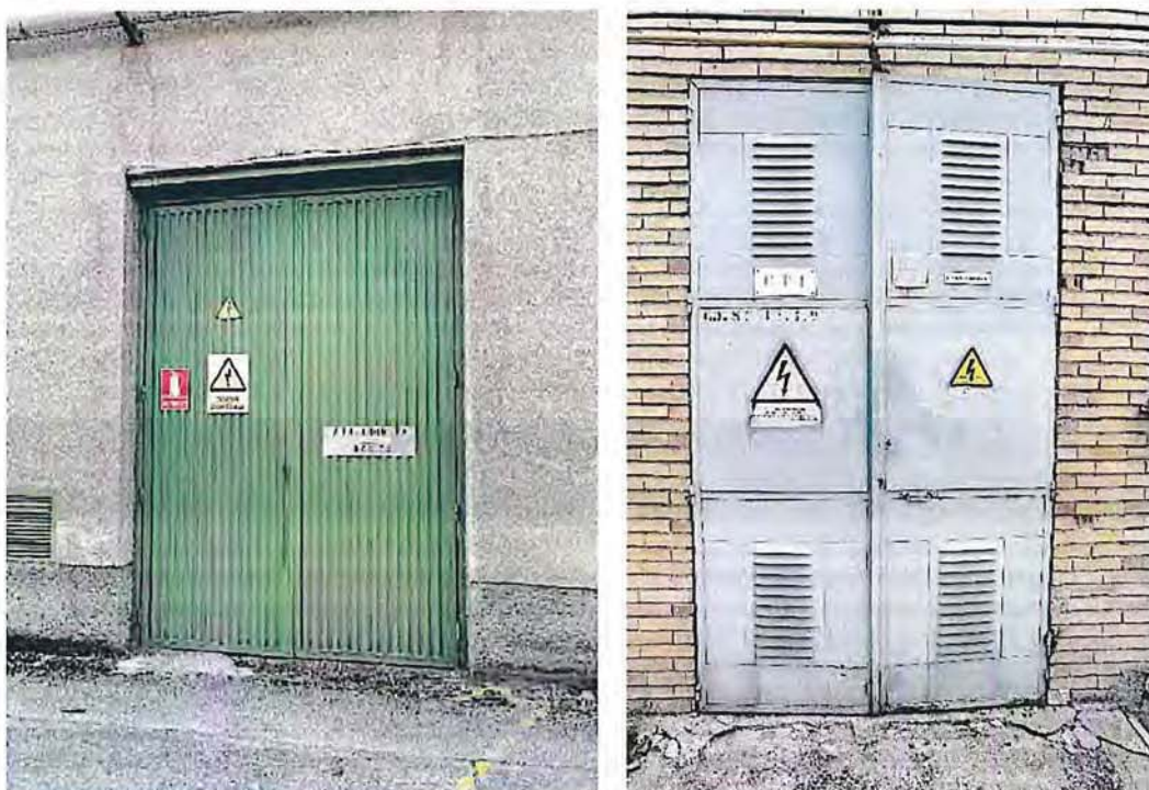
Figura 18: Vista exterior de los centros de transformación
