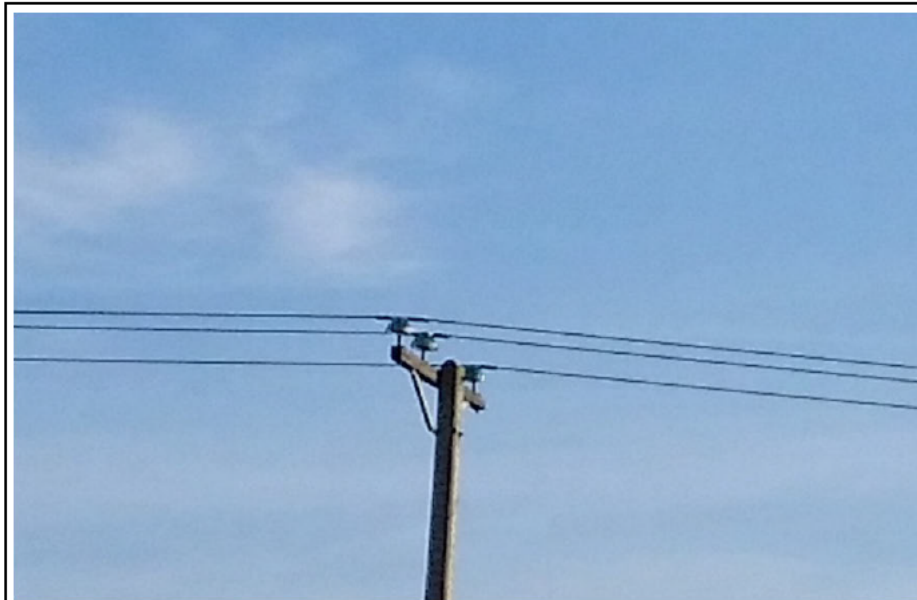
Fotografía 5. Detalle de cruceta.
