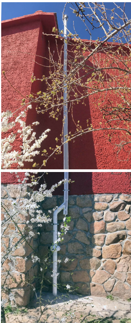
Figura 7 - Conducto de extracción, extractor y expulsión en cubierta
