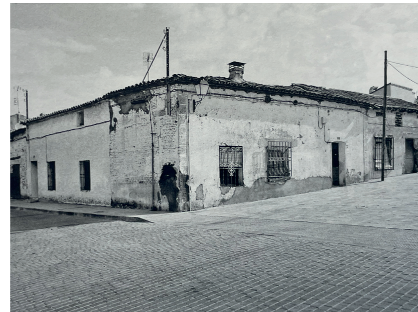
Valdeolmos, edificio. Fotografía de José Manuel Ablanado. En: Arquitectura y desarrollo, 2009. Fuente: Centro de Documentación de Medio Ambiente y Ordenación del Territorio.
