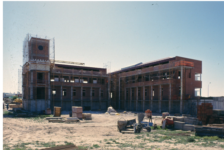
Construcción ayuntamiento nuevo, 1995. Fotografía: José Manuel Ablanado. Fuente: Centro de Documentación de Medio Ambiente y Ordenación del Territorio.
