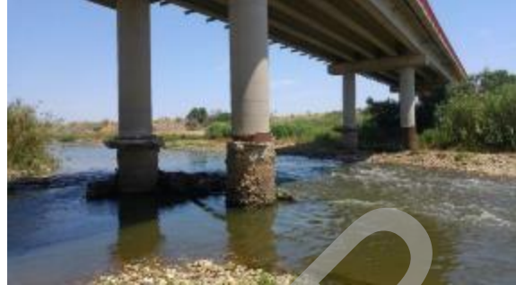
b) Fuerte incisión en los pilares del puente.
