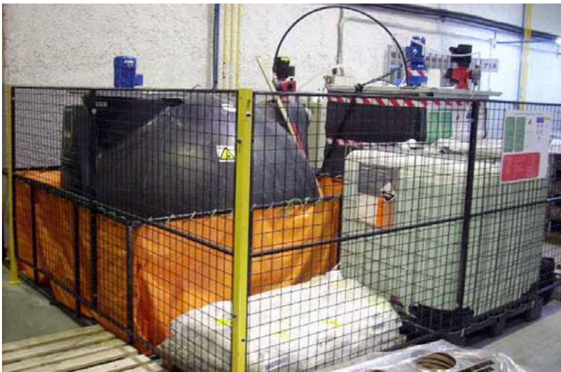
Sistema de inyección de oxidante para tratar etanos (TCA), usando persulfato sódico activado mediante aumento de pH (adición de sosa)
