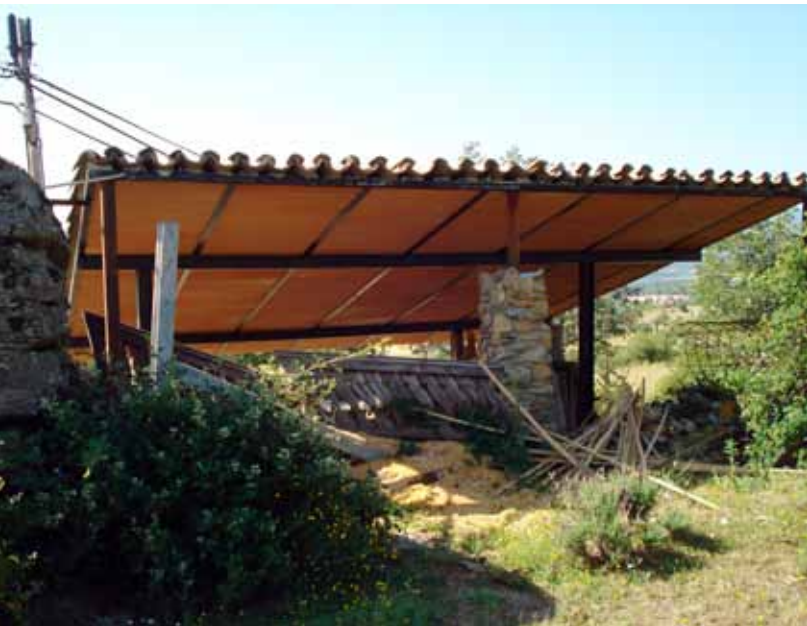
Ejemplo de construcción ilegal
