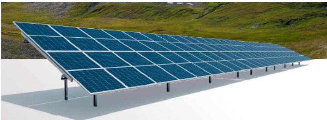
Figura 4.2.7.2.1- Imagen de placas solares y estructura fija. (Fuente: PEI)
