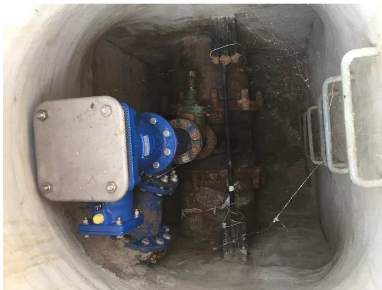
Figura 5: Registro CYII con ventosa en tubería de Ø500mm y conexión con tubería de Ø200mm.
