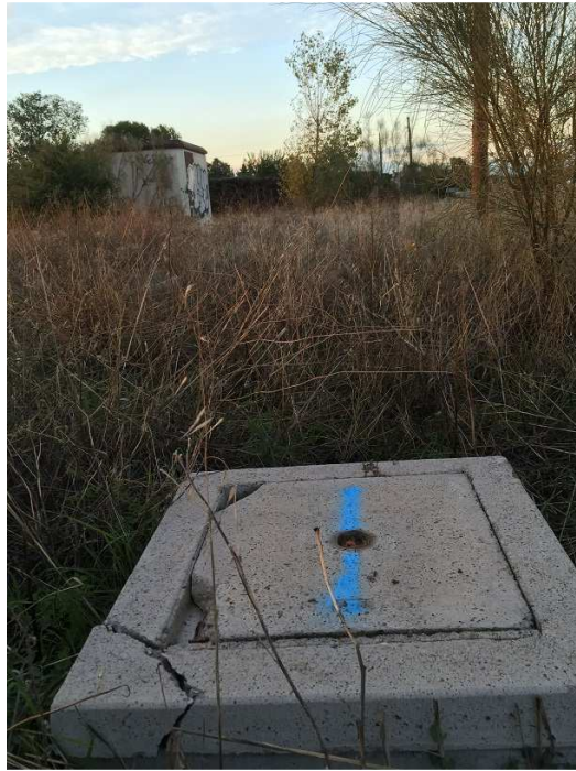
Figura 6: Arqueta tritubo sobre tubería de \varnothing 1200mm.
