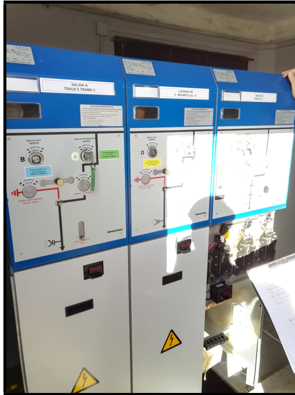
Detalle de interior de centro de seccionamiento
