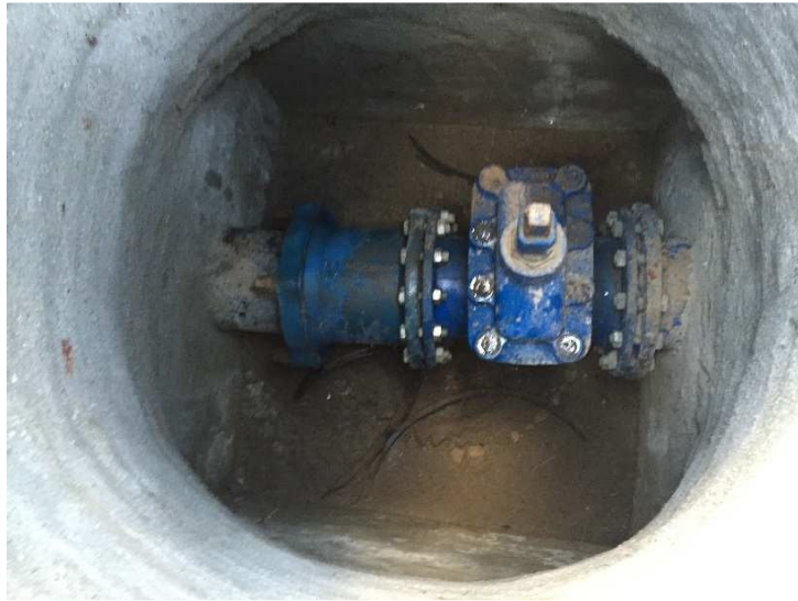
Figura 4: Registro CYII con válvula de corte en tubería de Ø200mm.
