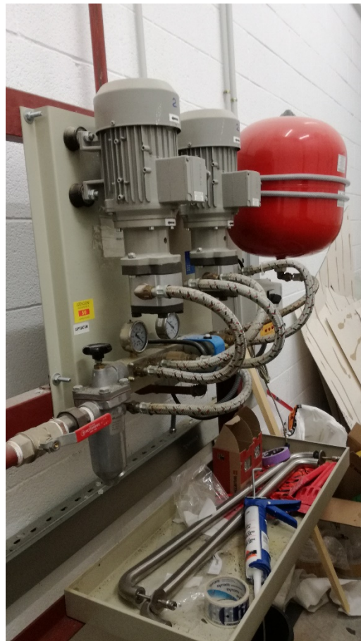
GRUPO BOMBEO CALDERAS
