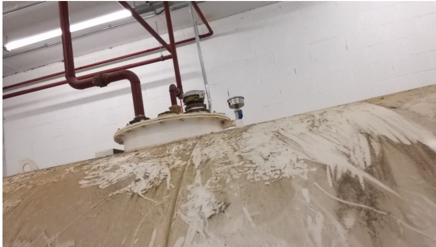
DEPÓSITO LAPESA LFD20P – GRUPOS ELECTRÓGENOS
