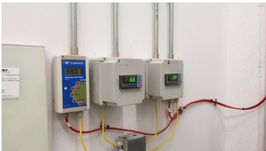
SEÑALES DE NIVEL DE LLENADO Y DETECTOR DE FUGAS
