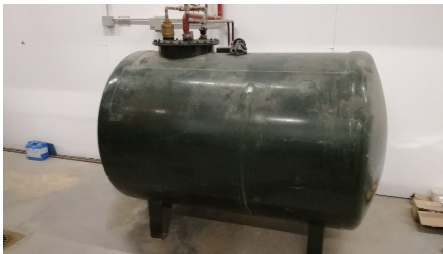
DEPÓSITO NODRIZA – GRUPO ELECTRÓGENO
