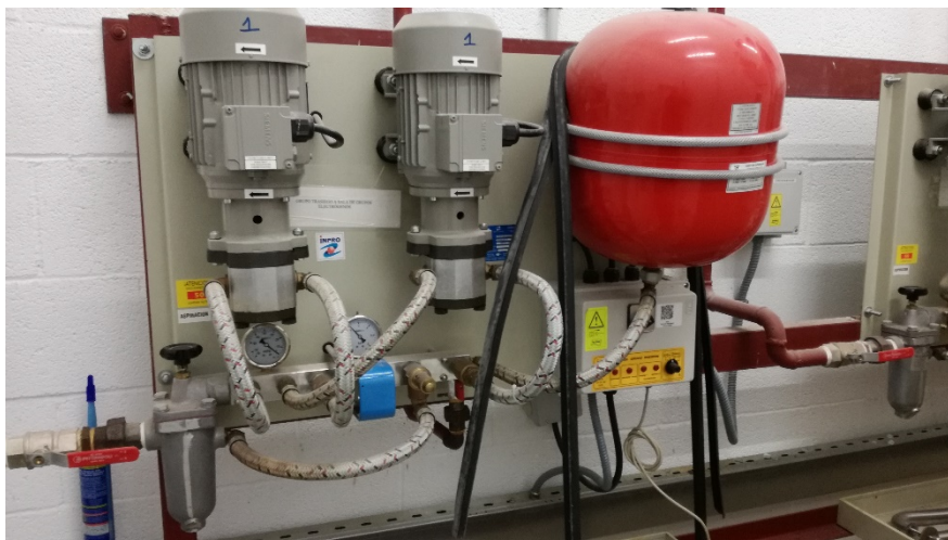
GRUPO BOMBEO GRUPOS ELECTRÓGENOS
