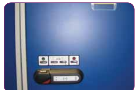
Puerta de una de las cabinas, con acceso codificado
