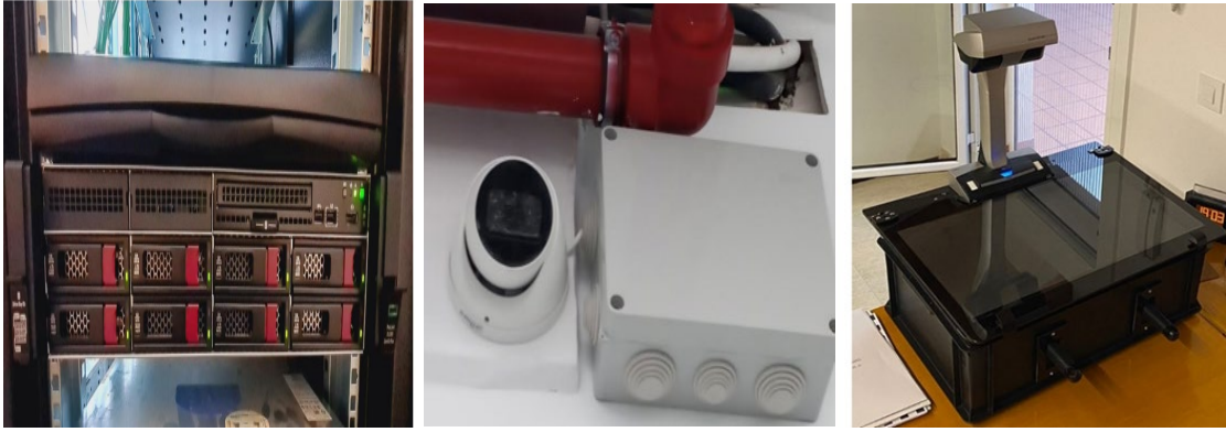
Subvención Entidades Privadas. Línea equipamiento archivo 2023. Izquierda: Fundación Albéniz (servidor). Centro: Real Fábrica de Tapices (cámara de vigilancia instalada en el Archivo). Derecha: Real Casino de Madrid (escáner).
